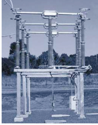
Resim 23.3 Tek döner izolatörlü (döner izolatörü ortada) ayırıcılar
